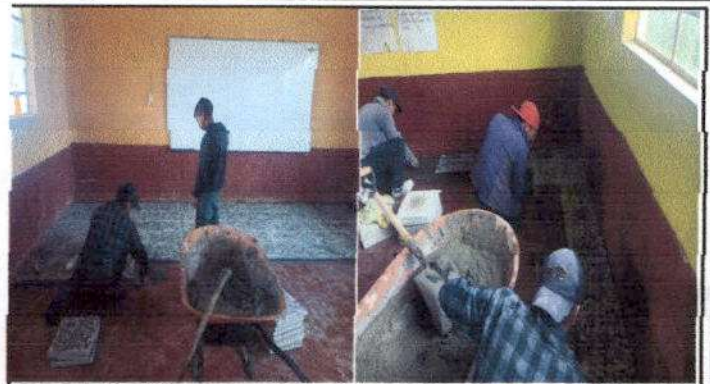
Foto 2: El albañil y sus ayudantes colocando el piso de granito en las aulas
